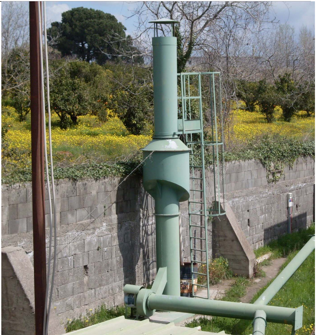
Figura 17 – Panoramica del sistema di abbattimento ad umido e delle condotte
