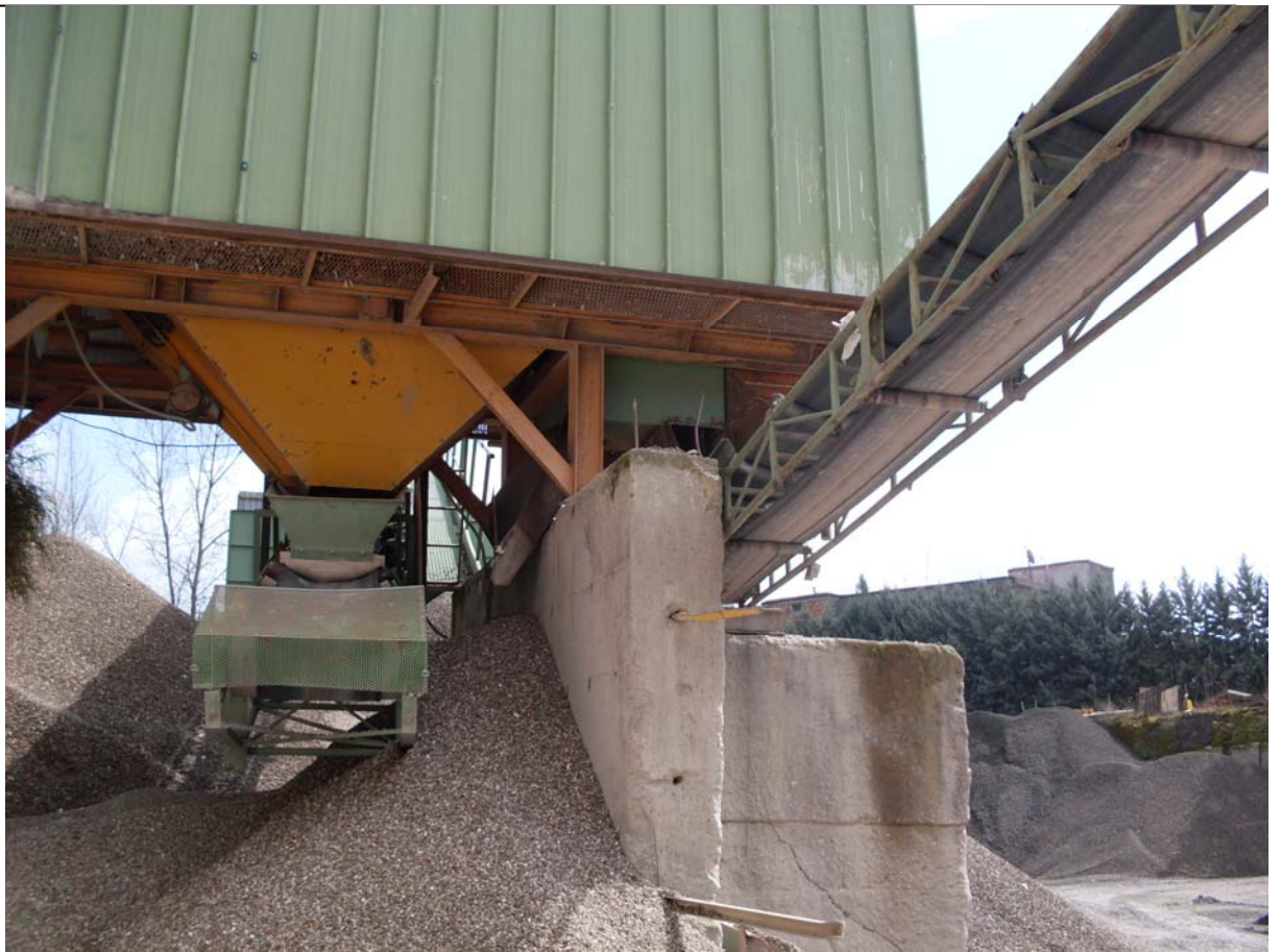
Figura 9 – Particolare del sistema di vagliatura
