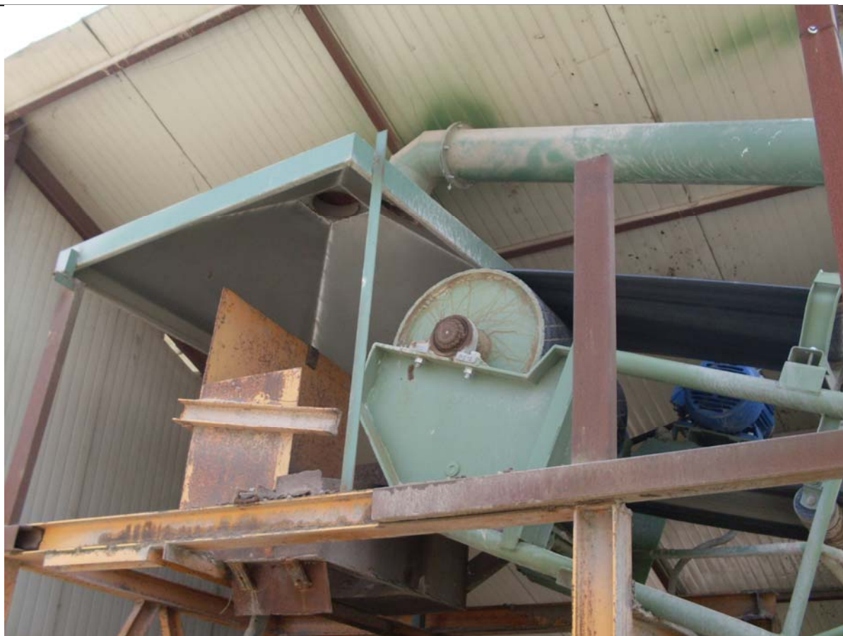
Figura 16 – Particolare della cappa di aspirazione posta sul vibro- vaglio
