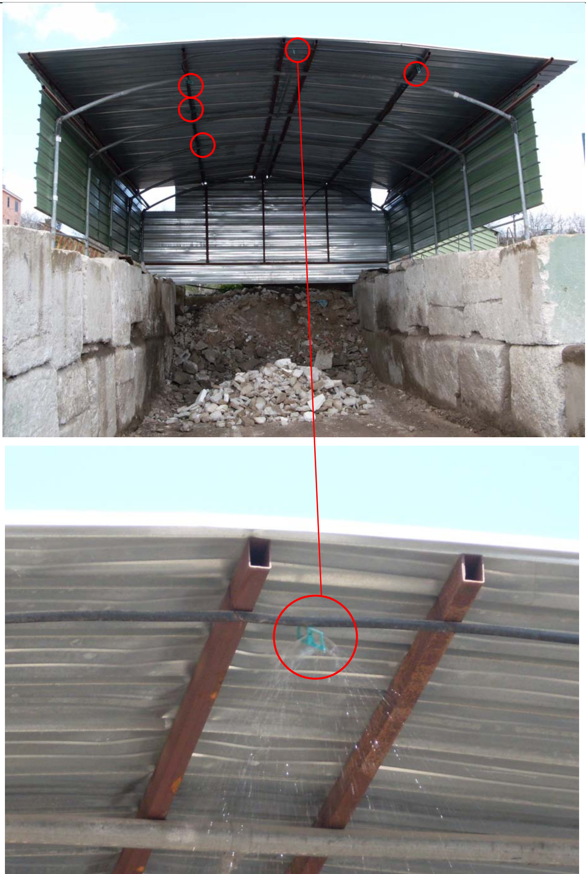
Figura 14 – Tettoia adibita a conferimento, selezione, cernita e messa in riserva Tip. 7.1 con particolare degli ugelli
