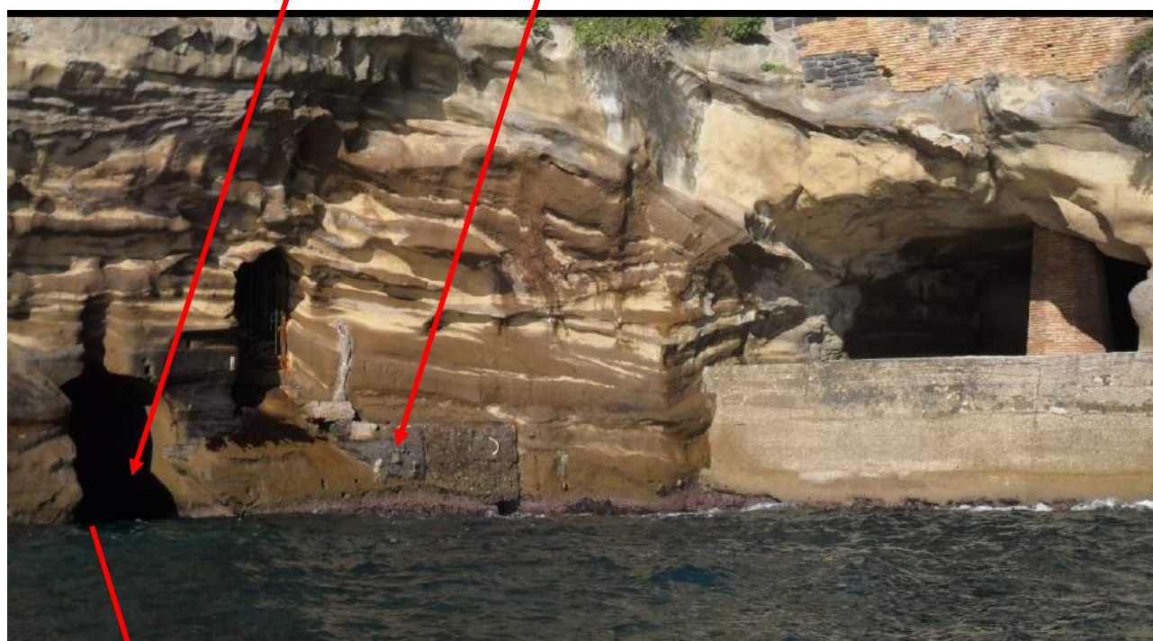
Figura 12 Confronto tra fotografie pregresse (almeno 10 anni fa) e lo stato attuale. Le frecce indicano il basamento al piede della falesia staccatosi. In particolare la grotta a sinistra presenta allo stato i piedritti (pareti laterali) che giungono in acqua mentre prima erano limitati dal basamento tufaceo
