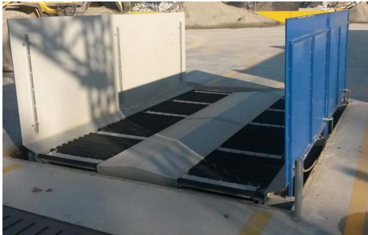
Figura 85. Tipica installazione impianto lavaggio gomme
