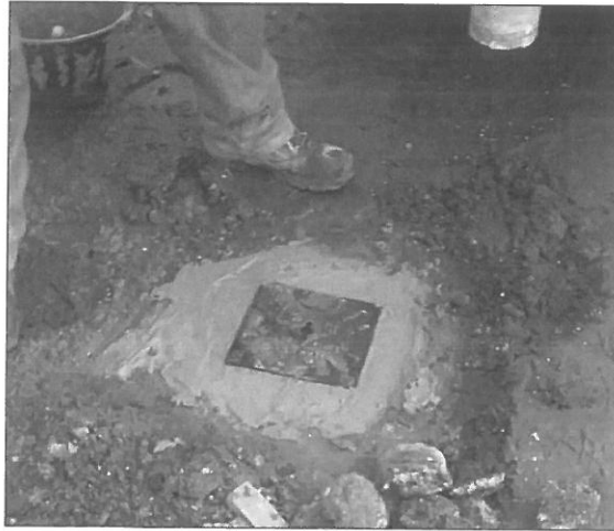
pozzetto carrabile piezometro S1
