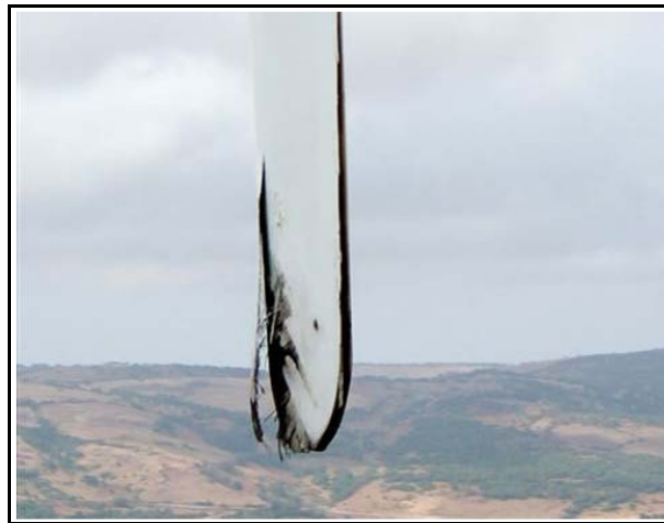
Figura 1 estremità di pala danneggiata da fulminazione atmosferica
