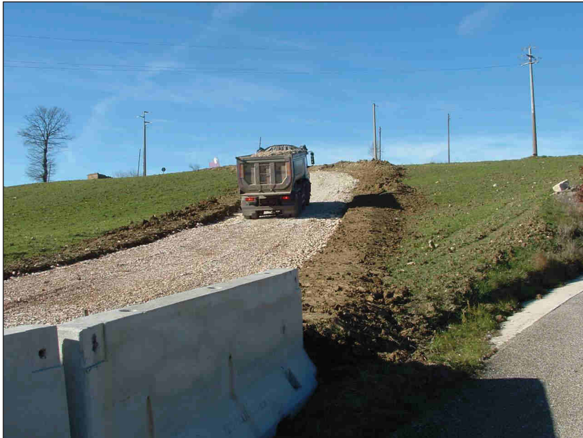
Figura 42 – Raccordo con la S.P. 24 in fase di realizzazione da altro operatore per il parco eolico di Circello.
