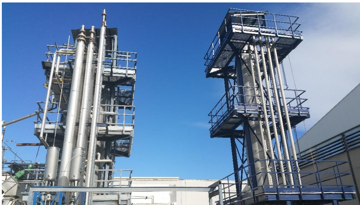
Impianto pilota Ingelia in Naquera
