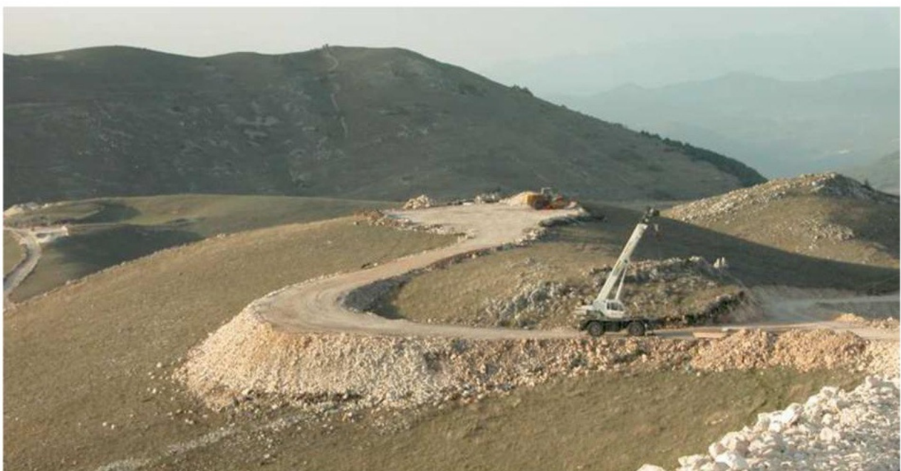
Esempio di trasporto di viabilità interna ad un parco eolico (nella foto un tratto in rilevato)
