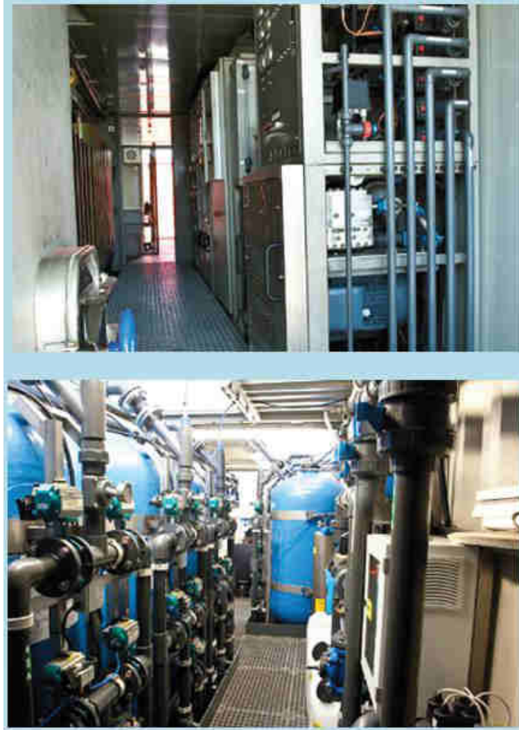
Figura 19 - Vista interna del container
