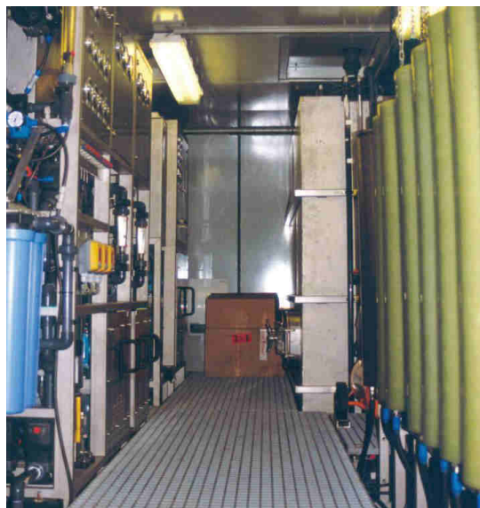
Figura 16 - Impianto di Osmosi inversa alloggiato in container
