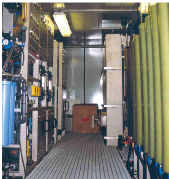
Figura 6 - Impianto di Osmosi Inversa alloggiato in container
