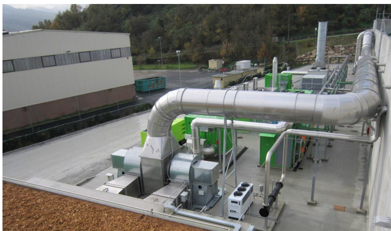
Figura 22: vista tipo dell'area di cogenerazione
