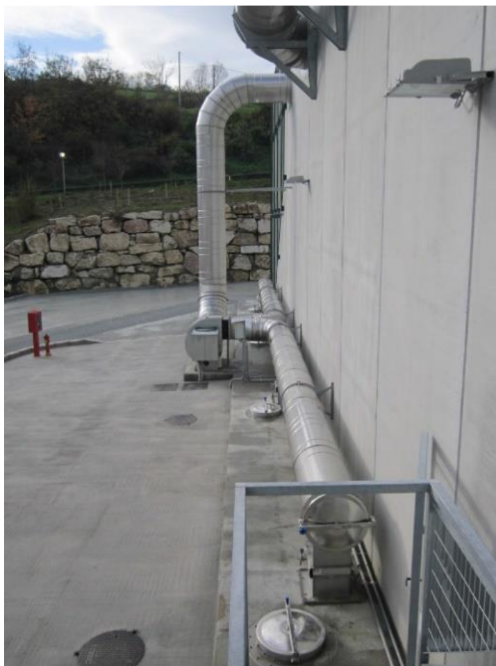
Figura 25: Ventilatore tipo insufflazione maturazioni
